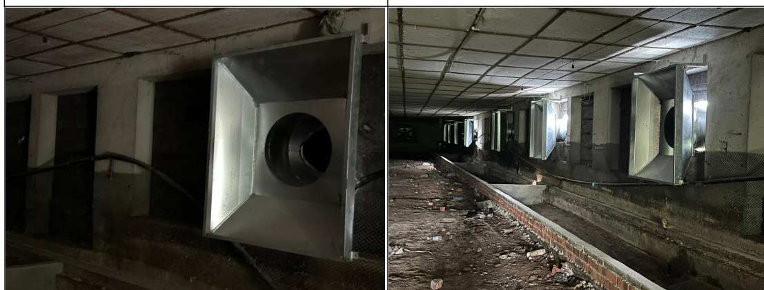
粪便暂存间内集气罩
