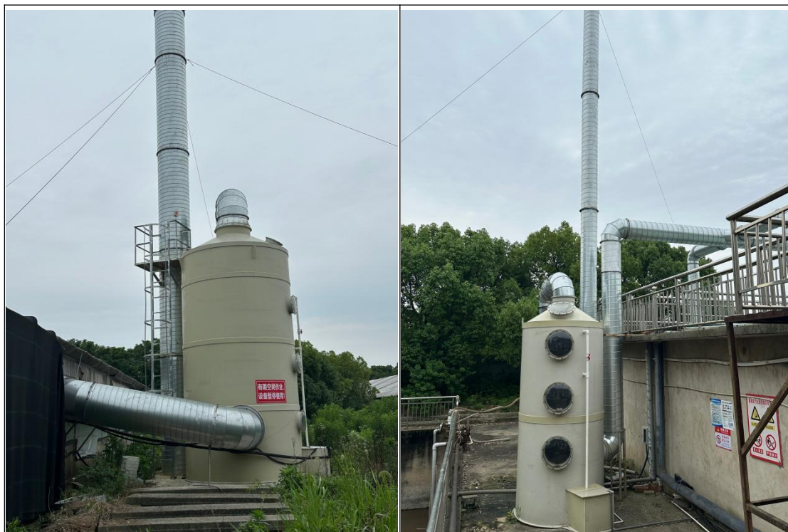
TA001 生物喷淋除臭塔
