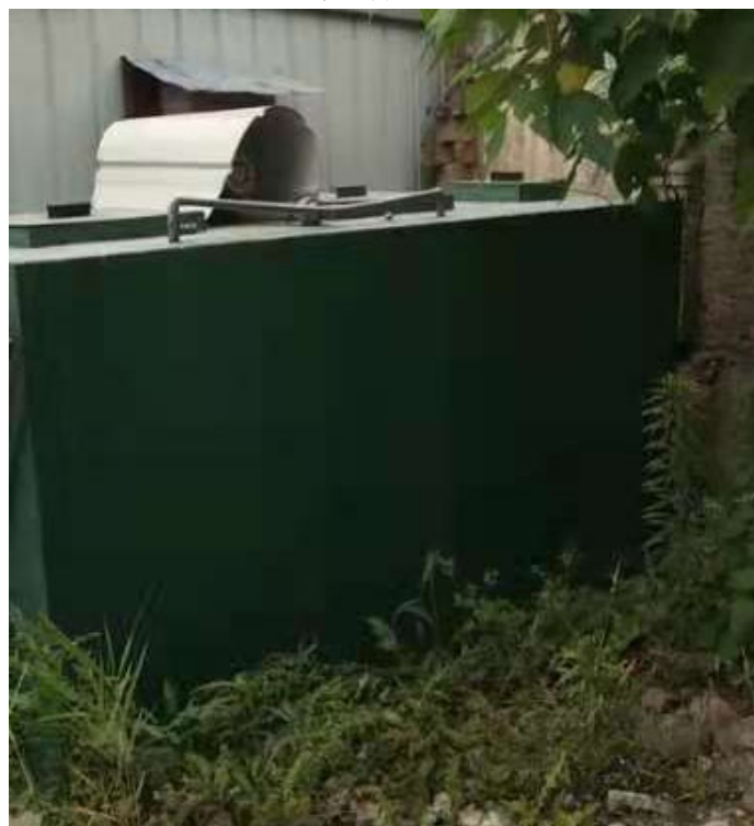
一体化污水处理装置
