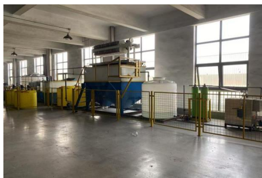
污水处理设施
