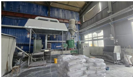
混料自带除尘器
