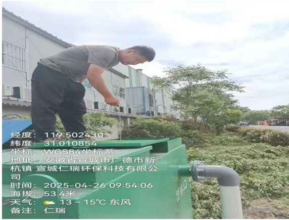
生活污水排放口
