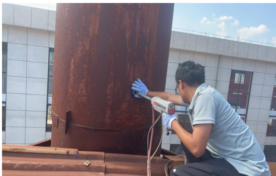
车间废气排放口
