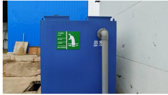
废水治理设施
