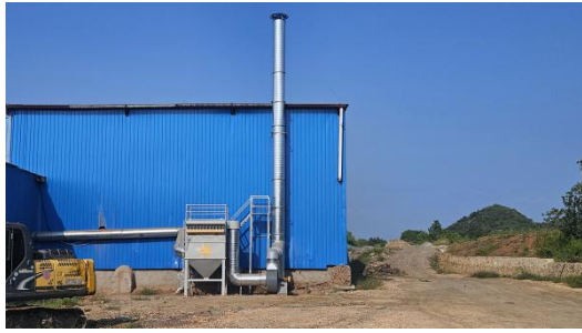
废气治理设施
