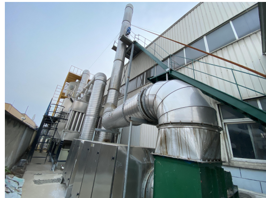
造粒废气治理设施
