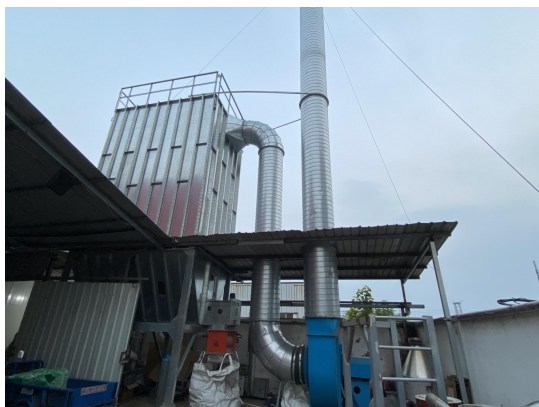
切割、打磨废气治理设施
