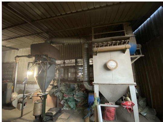
破碎粉尘治理设施
