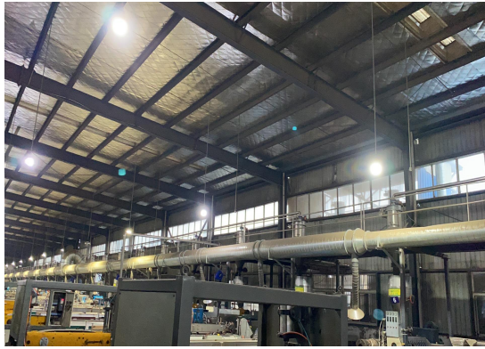
废气收集管道
