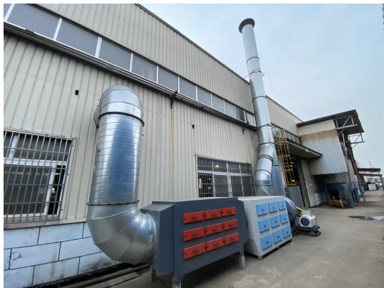
2#挤出废气治理设施
