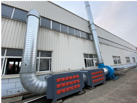
1#挤出废气治理设施
