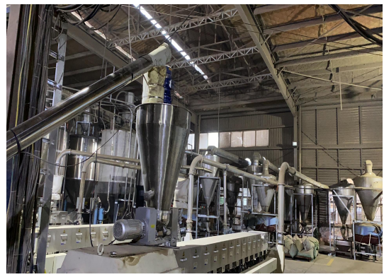
废气收集管道
