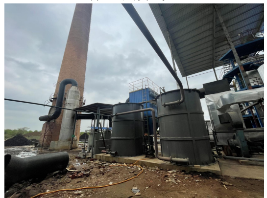
SNCR+旋风除尘+布袋除尘+双碱法脱硫
