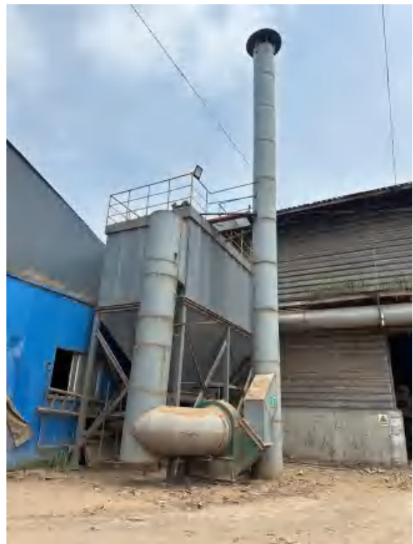
破碎废气排气筒
