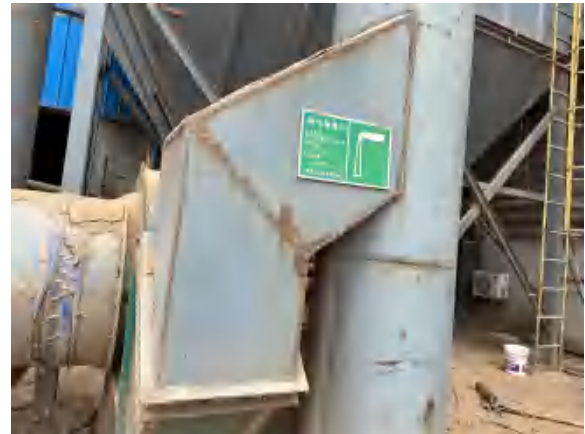
破碎废气排气筒标识牌
