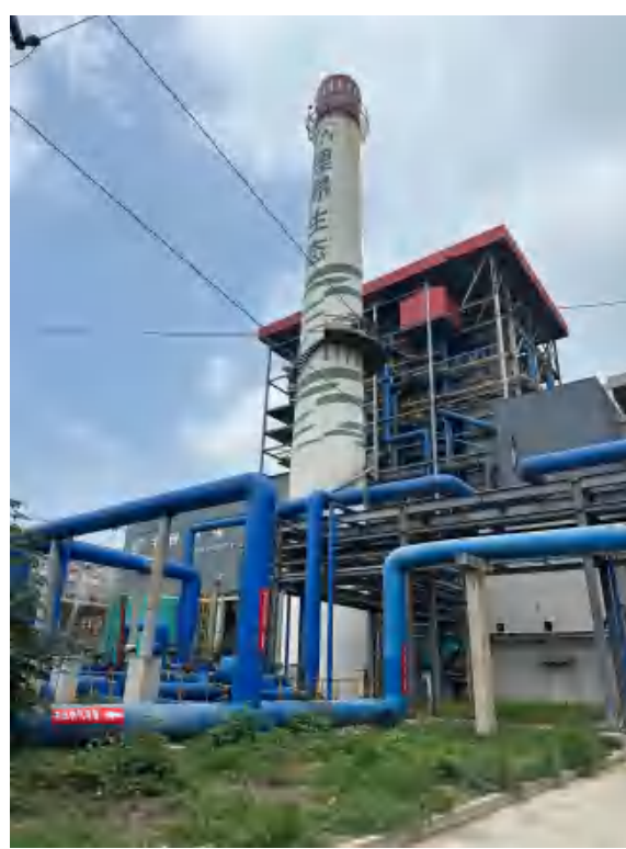
三期项目锅炉排气筒
