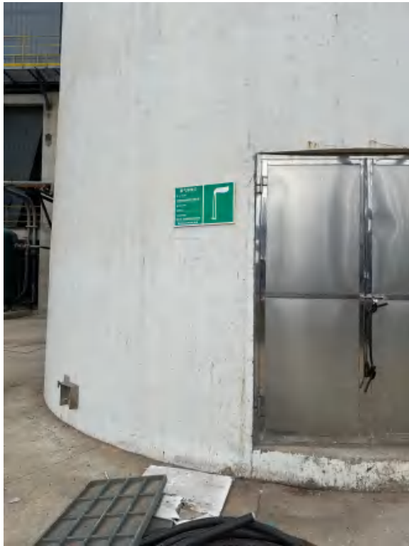
三期项目排气筒标识牌
