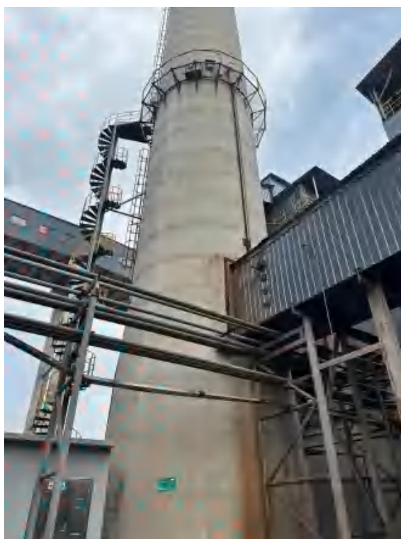
一期、二期项目锅炉排气筒
