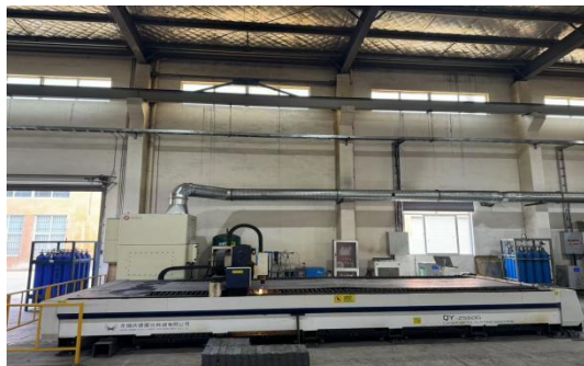
切割废气治理设施
