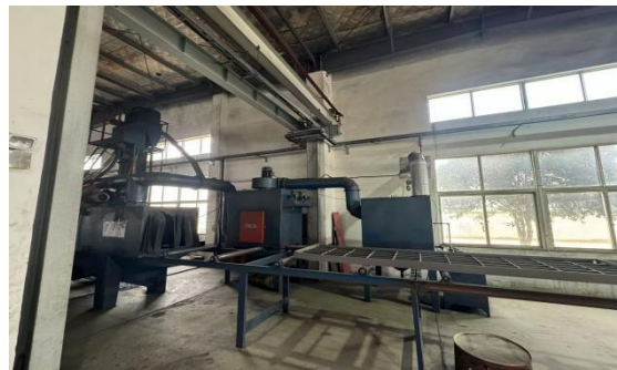
抛丸废气治理设施
