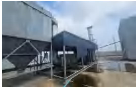
布袋除尘器+光氧催化+活性炭处理设施
